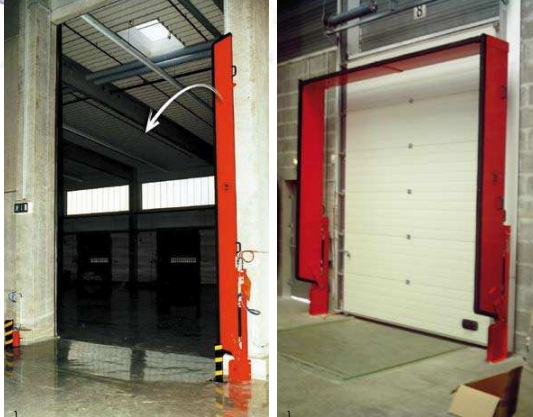
1 Barrière automatique à déclenchement sur sprinklage.
