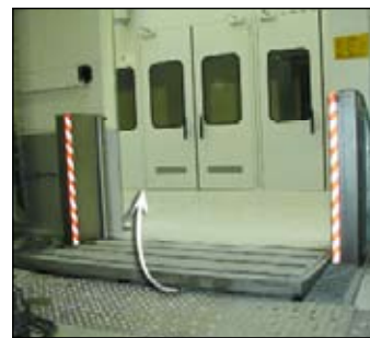
Barrières anti-pollution Rétention Eaux d'incendie
