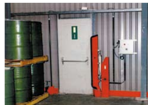
▲ Système de commande manuelle ou automatique (connection sur alarme...).
